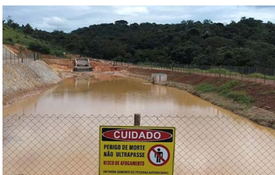
Bacia de contenção e dissipador do sistema de drenagem do Antares
