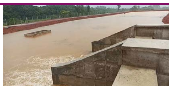
Bacia de contenção da rede Centaurus em pleno funcionamento
