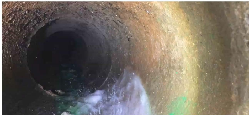
Figura 7 – Água lançada do caminhão pipa e fluindo pela tubulação
