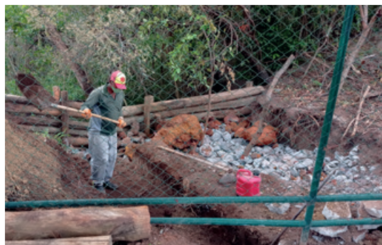
Trabalho de contenção das águas de chuva com caixas de infiltração para preservação da área verde do RK
