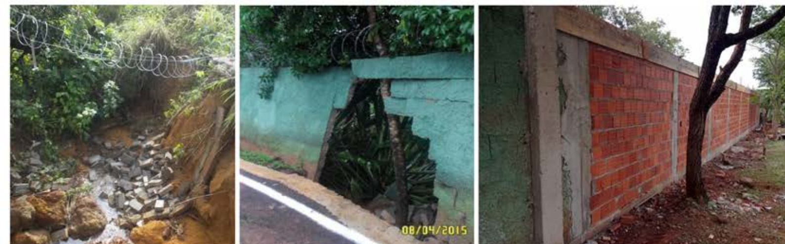
Muros danificados ou derrubados em decorrência do acúmulo das águas pluviais que não tinham como escoar
