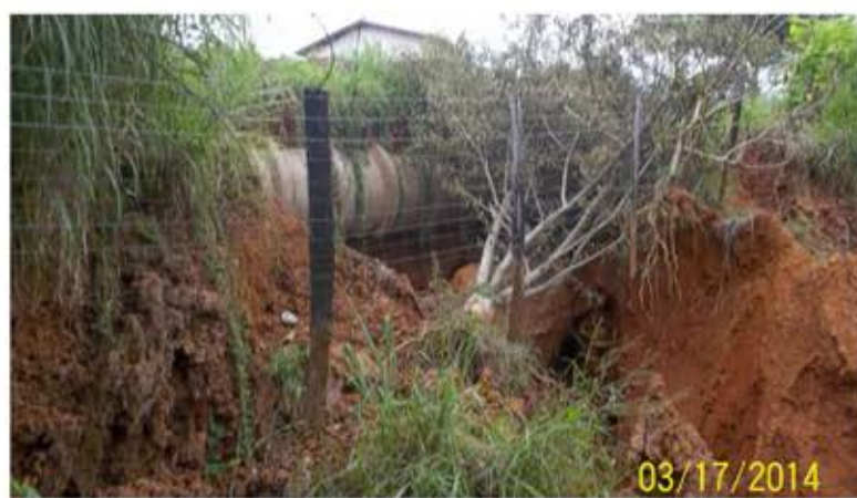
EROSÃO 2: Rua do Mirante, formada pelo escoamento superficial das águas de chuva das ruas do Antares
