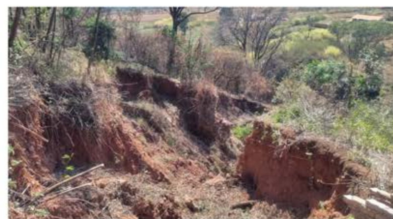
EROSÃO 3: Rua do Mirante, próximo à ch/B30, formada pelo escoamento superficial das águas de chuva
