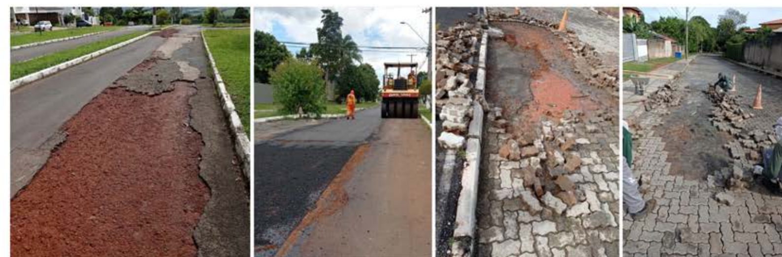
O asfalto da avenida e os bloquetes das ruas eram constantemente arrancados pela força das águas, o que além do transtorno que traziam também prejuízo para todos os condôminos
