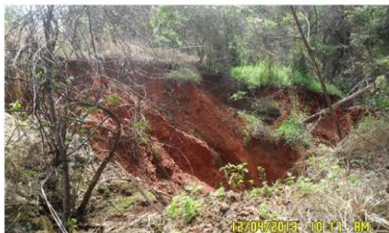
EROSÃO 1: Rua do Mirante, abaixo do Laguinho, formada pela vazão do lago e adjacências
