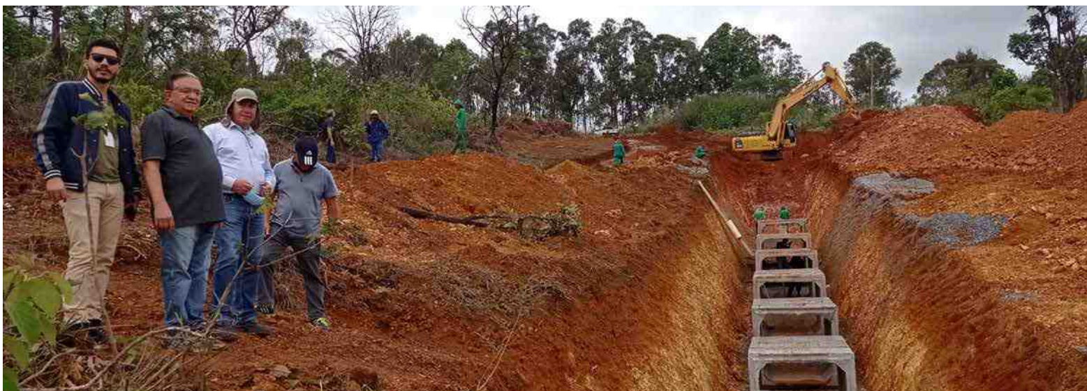
Visita de acompanhamento e fiscalização da obra por técnicos da Novacap e engenheiros responsáveis pela sua execução
